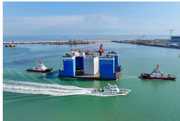
中粮油脂连云港赣榆港区粮油码头项目沉箱安装顺利完成
